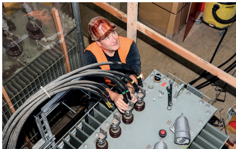
... genauso, wie die Installation von Trafostationen.
